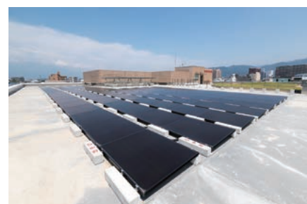
本部棟の太陽光発電システム
